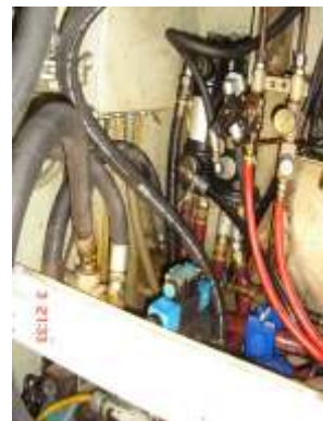
Modelo FF5 instalado a la entrada de dos intercambiadores de calor en la maquina No 3
