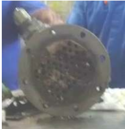
Intercambiador de Calor, desmontado después de 1 mes con el tratamiento de Fluid Force
